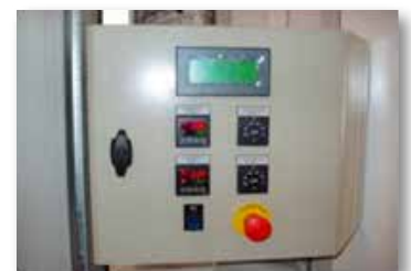
Kontrolltavla med PLC och digital pekskärm
