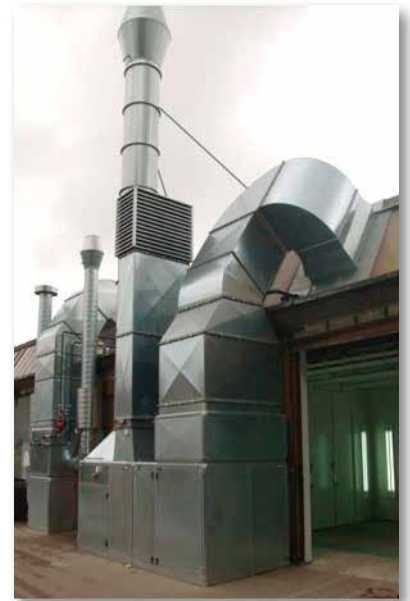
Aggregat med vattenvärmebatteri.
