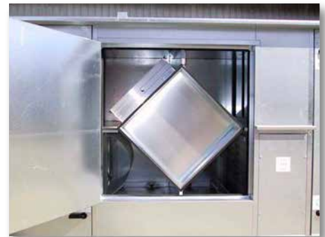
Mindre aggregat med enkel korsvärmeväxlare.
