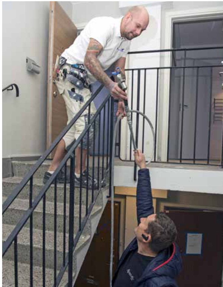
Mattias Westman på Blåders Måleri får hjälp av Martin Westerén från Ljungdahls Färg att dra upp slangen till översta våningen. Det går snabbare att dra slang via trapphuset än att flytta runt sprutan i fastigheter där hiss saknas.
